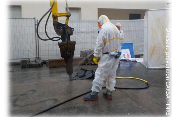
Burinage au marteau piqueur en vue d'une réfection complète de la chaussée Sous-section 3
