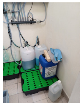
Bacs de rétention
